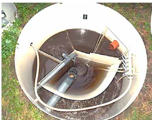
1 pav. AT-6 buitinių nuotekų valymo įrenginis Fig. 1. Household wastewater treatment plant AT-6
