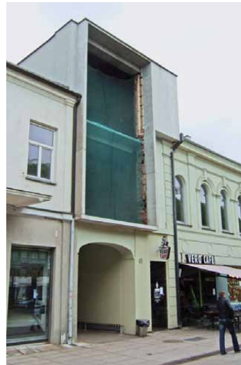
3 pav. Laisvės alėjos „Tulpė“ perstatę investitoriai „pamiršo“ užbaigti antstatą virš įvažos
