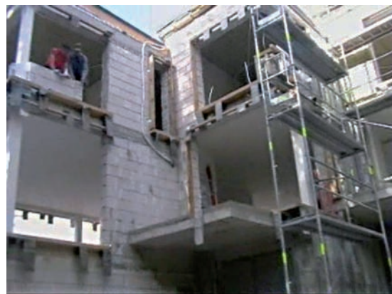
3 pav. Statybvietėse užfiksuotos nesaugios darbo vietos aukštyje
